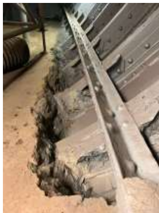
aufgebrochener Ballastbeton an Stb-Seite vorn
